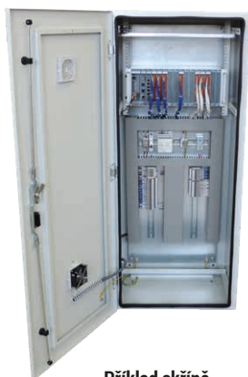
Příklad skříně pro menší rozvodnu
